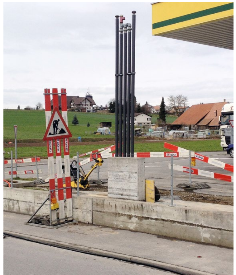
Abb. 1: Druckausgleichsleitungen einer Tankstelle.
